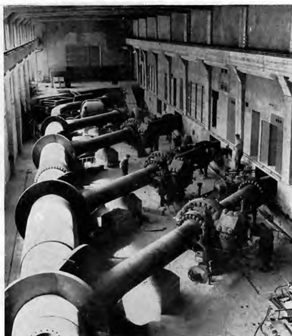
Bild 16: Verteilrohrleitung der Zentrale Riddes, Anlage Mauvoisin, Walliser Alpen, Schweiz. Gebrüder Sulzer AG, Winterthur.
