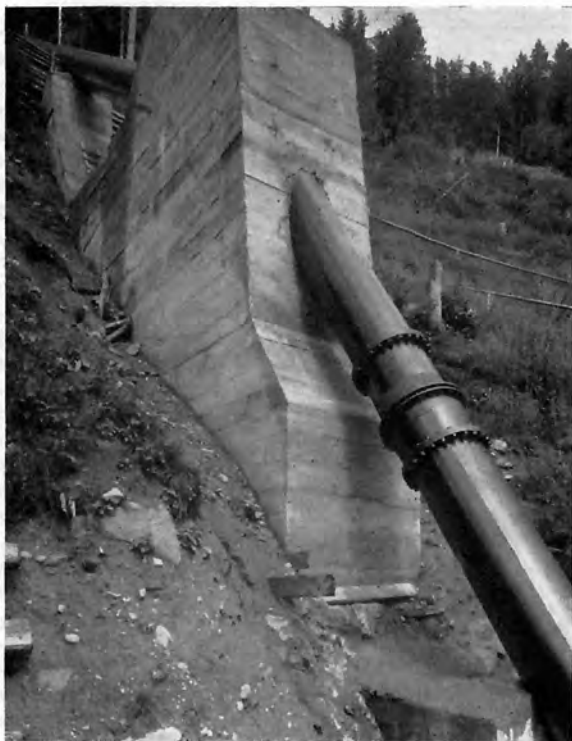
Bild 20: Festpunktblock bei Beginn einer Steilstrecke. Druckrohrleitung des Kraftwerkes Debanf II der TIWAG. Waagner-Biró AG, Wien-Graz
