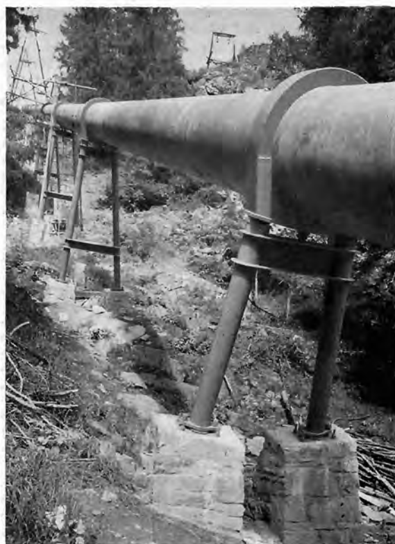
Bild 11: Druckrohrleitung des Kaiserbachkraftwerkes der TIWAG, Rohrbrücke. Waagner-Biró AG, Wien-Graz
