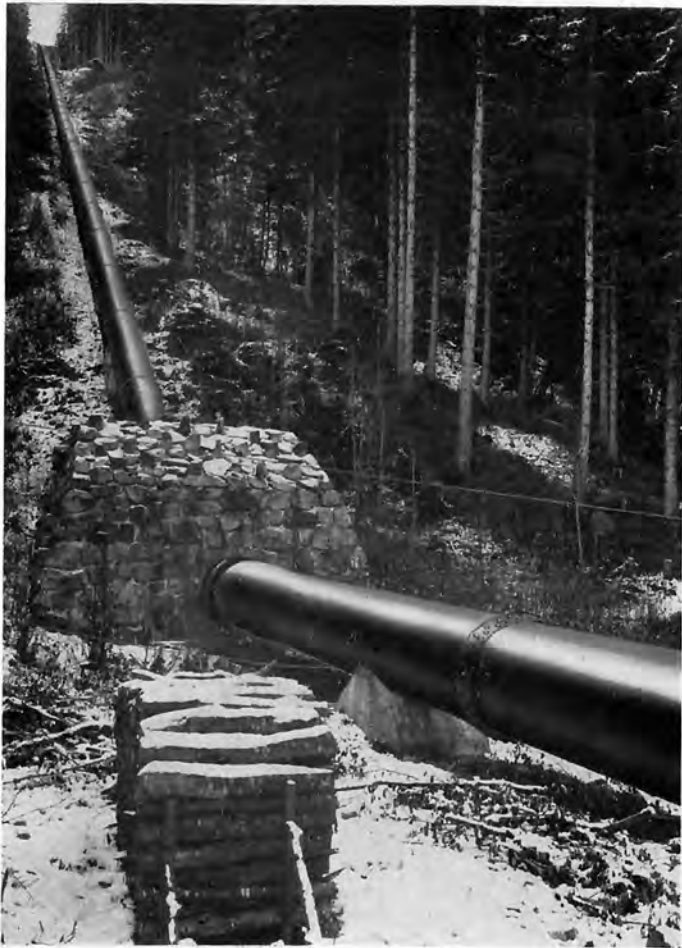
Bild 29: Druckrohrleitung des Kraftwerkes Schneiderau (Stubach II) der Österr. Bundesbahnen
