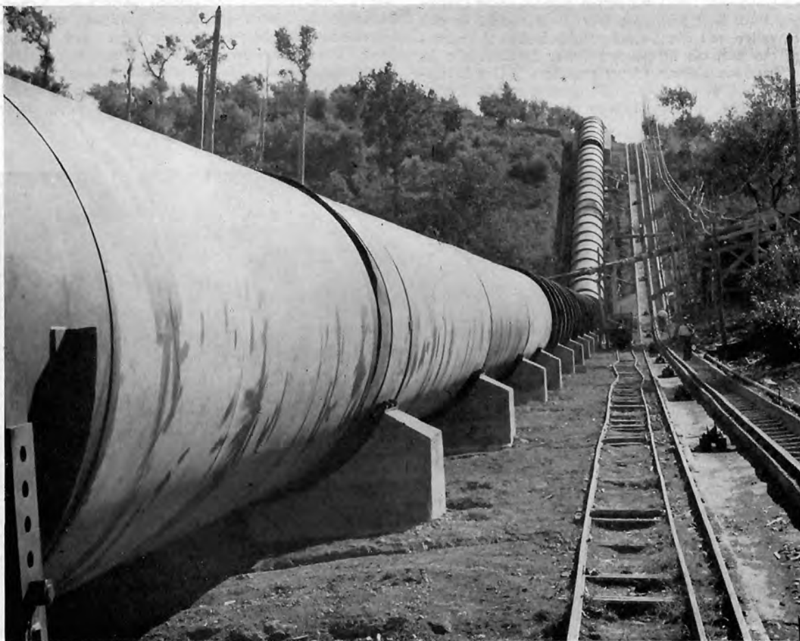
Bild 21: Lagerung einer Druckrohrleitung auf Gleitsätteln und Betonsockel. Anlage Mucone II der Soc. Meridionale di Elettricità, Napoli. Soc. TERNI, Terni
