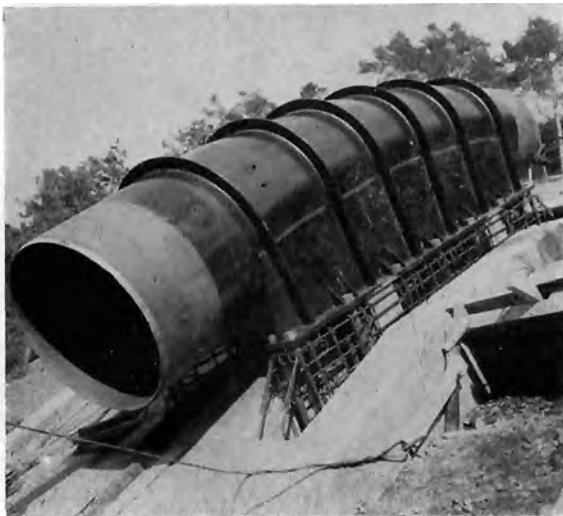
Bild 14: Krümmer einer freien Druckrohrleitung, ohne Betonhaube im Festpunktblock verankert. Druckrohrleitung Riddes der Anlage Mauvoisin, Walliser Alpen, Schweiz. Gebrüder Sulzer AG, Winterthur
