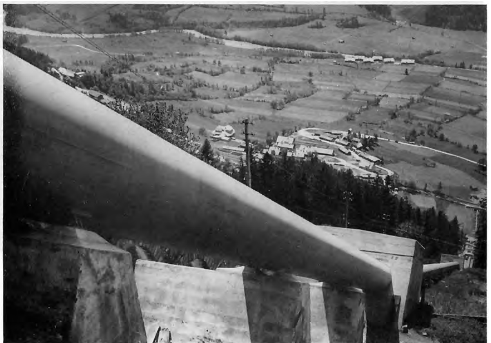
Bild 62: Druckrohrleitung der Laufwerkstufe Reifheck, VOEST-Linz
