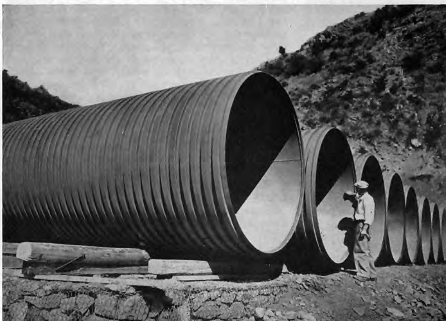
Bild 98: Bandagierle Rohre auf dem Lagerplatz für das Kraftwerk Mucone I der Soc. Meridionale di Elettr., Napoli. Ausführung Soc. TERNI, Terni
