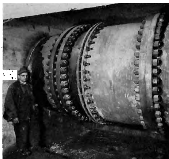
Bild 17: Stopfbüchsen-Dehnstück der Druckrohrleitung des Kraftwerkes Uttendorf (Stubach III) der Österr. Bundesbahnen. Waagner-Biró AG, Wien-Graz
