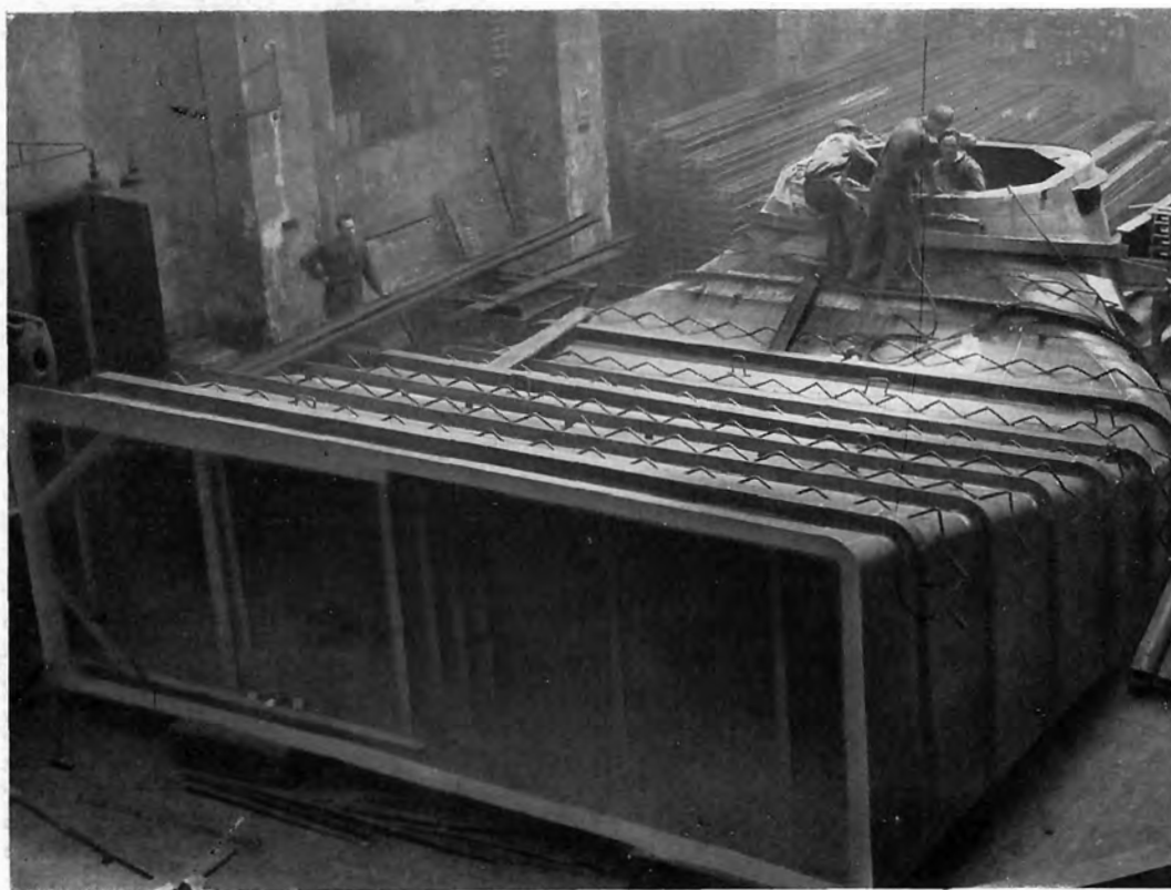
Bild 7: Kraftwerk Ernestina. Saugrohrpanzerung. Maschinenfabrik Andritz AG, Graz
