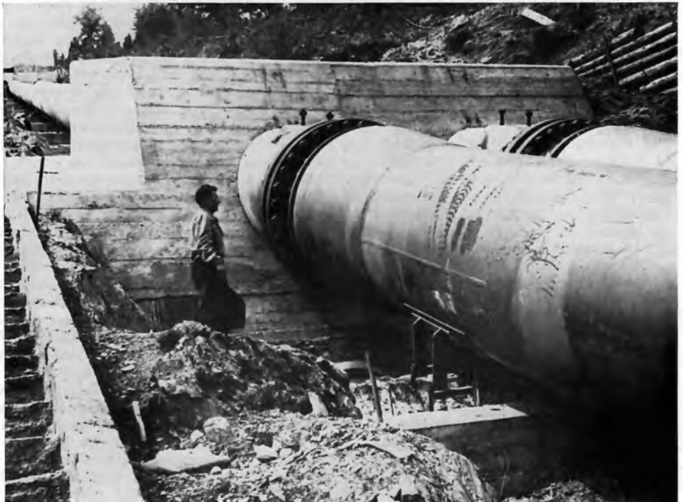
Bild 64: Druckrohrleitung der Hauptstufe Glockner-Kaprun der TKW, mittlerer Teil der Stränge III + IV (Festpunktblock, Mannlochverschlüsse, Stopfbüchsen-Dehnstücke). VÖEST-Linz
