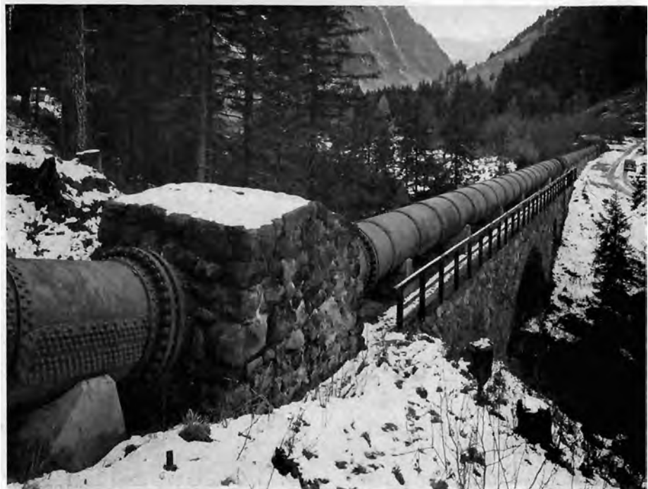
Bild 19: Festpunktblock einer freien Druckrohrleitung, Beton mit Bruchsteinverkleidung. Kraftwerk Schneiderau (Stubach II) der Österr. Bundesbahnen. Waagner-Biró AG, Wien-Graz
